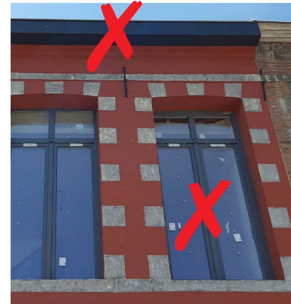
▲ Bac de corniche droit en panneaux stratifiés et châssis en PVC ne sont pas adaptés à un bâtiment du XVIII e siècle.
